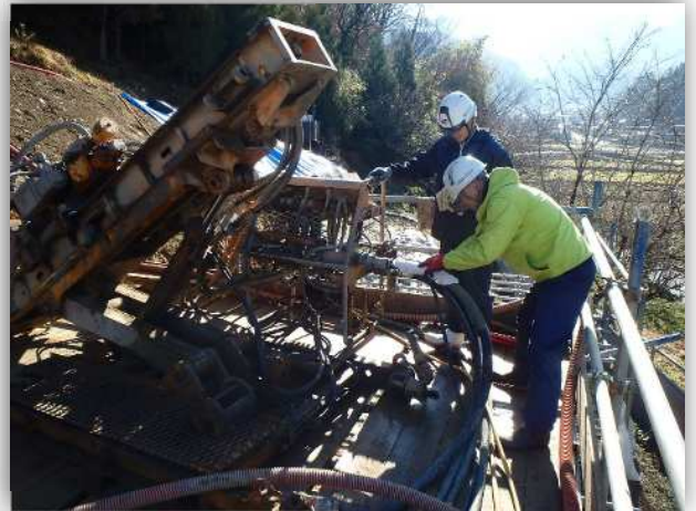
オイル漏れ部分の応急処置
